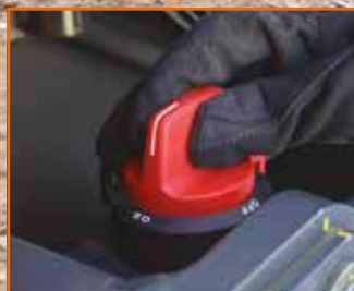
Sezionatore della batteria
