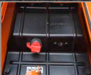
Sezionatore della batteria
