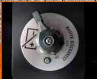
Sezionatore della batteria
