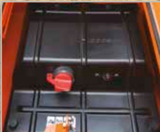
Sezionatore della batteria
